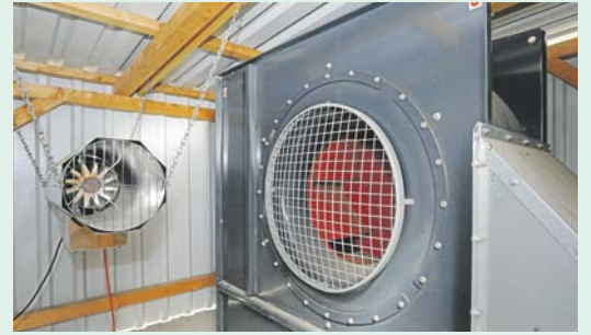
Neben jedem Silo stehen eingehaust das Lüftungsgebläse und der Heizer.
