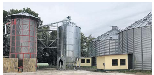
Kundenanlage zur Maistrocknung: links ein Rührschnecken-Trockner mit 75 t Kapazität, daneben ein ebenso großes Schwitzsilos mit Belüftungsmöglichkeit und rechts zwei Bintec-Silos mit jeweils ca. 950 t Kapazität. Die sonst auch zur Silobefüllung eingesetzte mobile Schnecke wird genutzt, um den vorgetrockneten, geschwitzten und wieder abgelüfteten Mais in die Bintec-Silos zur Endtrocknung und Lagerung zu fördern. FOTO: PRIVAT
