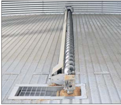
Die Fegeschnecke befördert das Restgetreide beim Entleeren in die zentrale Entnahmeöffnung.
