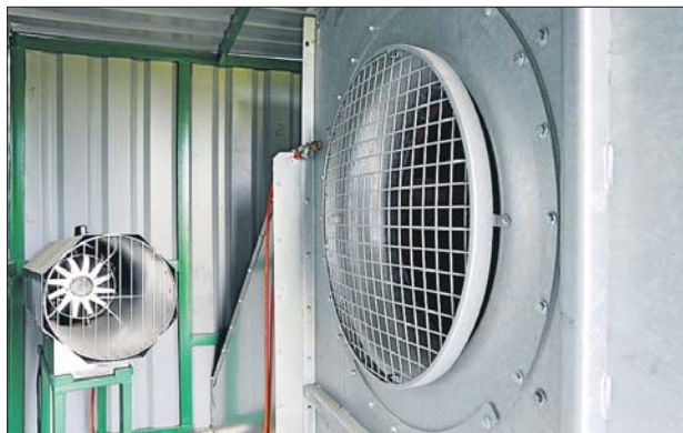
Bei drei Silos kann durch Heizbrenner vor den Gebläsen die Zuluft im Silo erwärmt werden.
