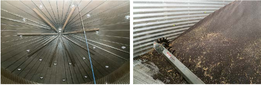
Blick ins Innere eines Silos: Einlagerungs-Verteiler, Belüftungsboden und Fegeschnecke sind wichtige Komponenten des Systems.
