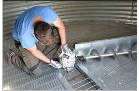
Prüfung des Zentralgetriebes an der Fegeschnecke.
